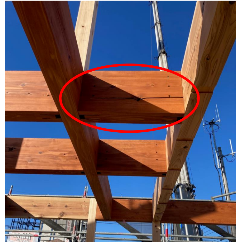
上棟時カケヤで打ち込むと横架材割裂
